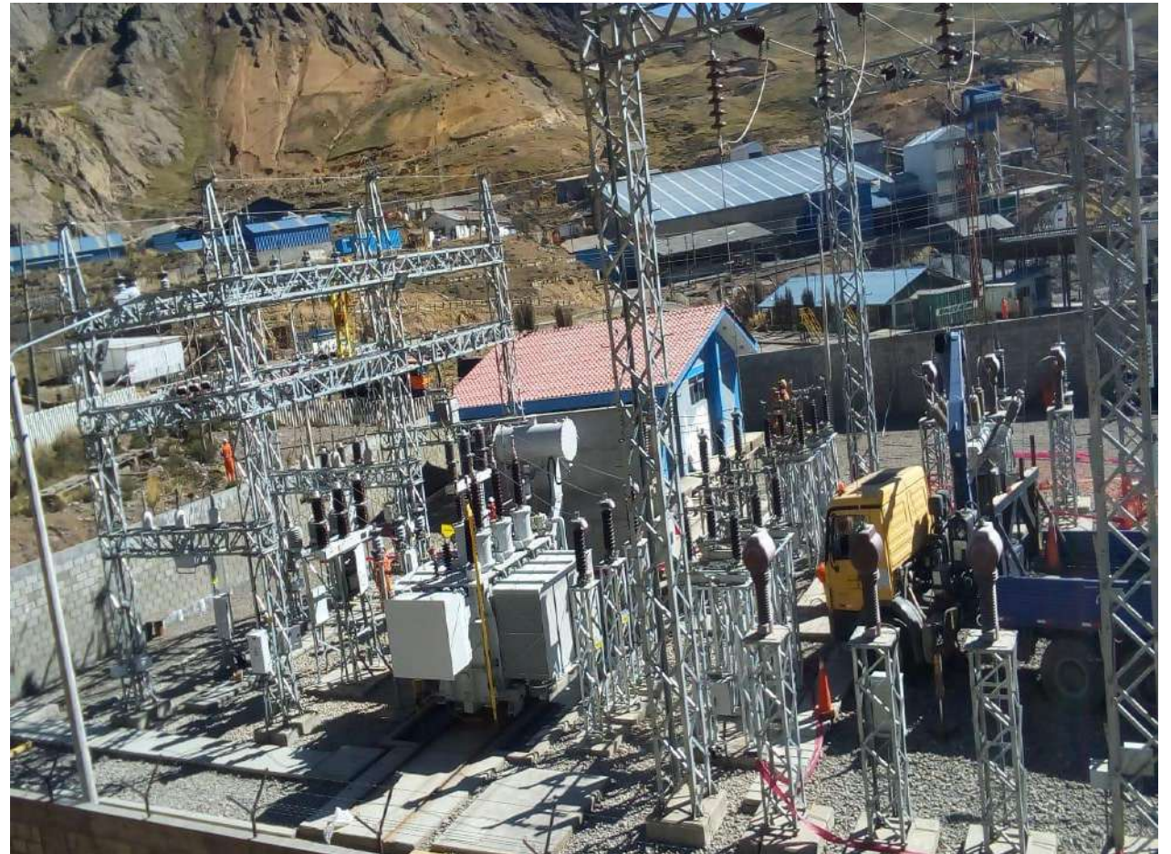
Subestación Eléctrica - Transformador 10MVA
